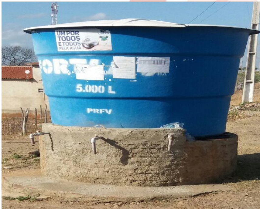
Figura 04 - Chafariz instalado – Zona urbana de Pilões/RN
