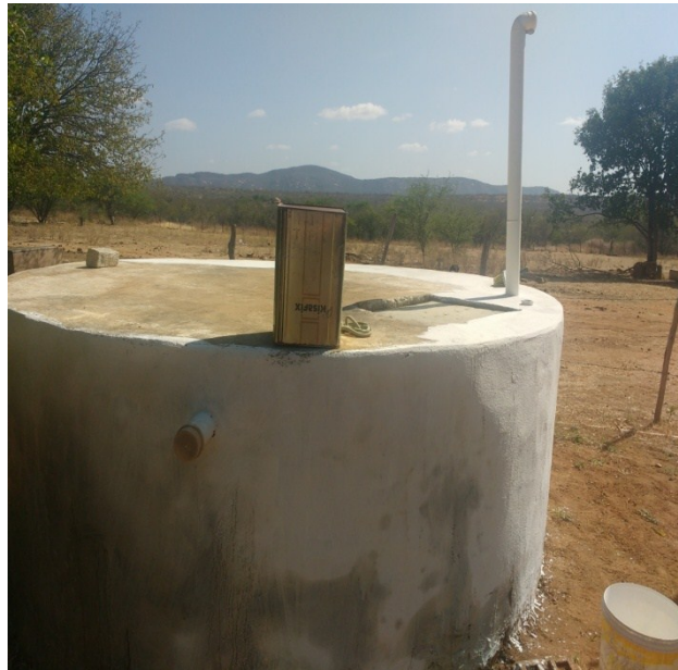
Figura 3: Exemplo de cisterna com vazamentos nas paredes.
