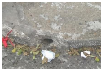
b) obstrução de boca de lobo com concreto pela própria comunidade.
