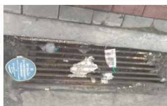
a) obstrução de boca de lobo gradeada e sarjeta por resíduos
