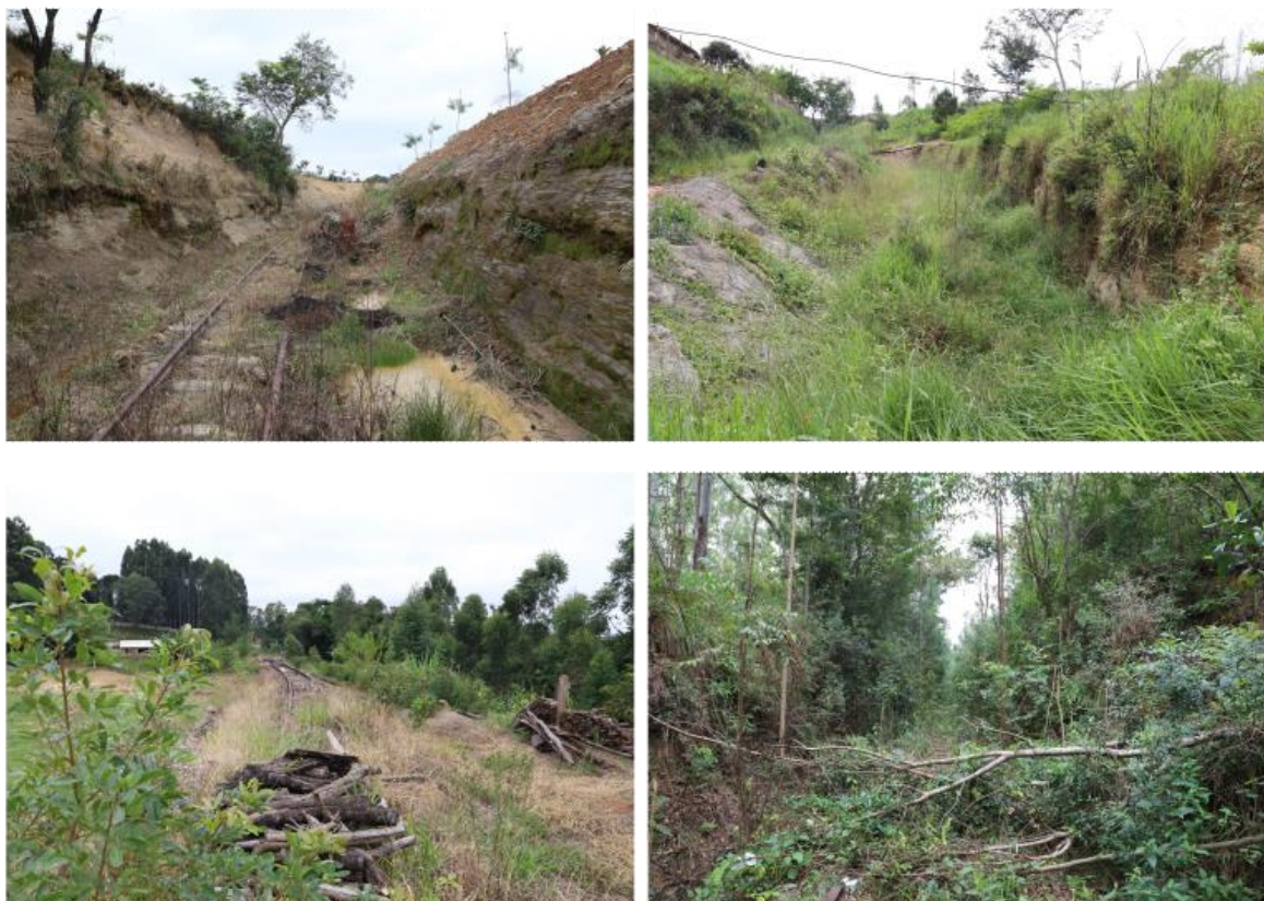
Figura 3 – A, B e D – Vegetação encobrindo os afloramentos. C e D – Troncos de árvores dificultando a passagem sobre os trilhos. Fonte: O autor
