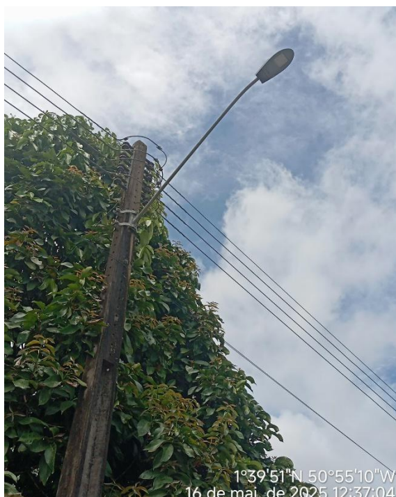
Figura 7: Poste de Iluminação pública na comunidade Cujubim
