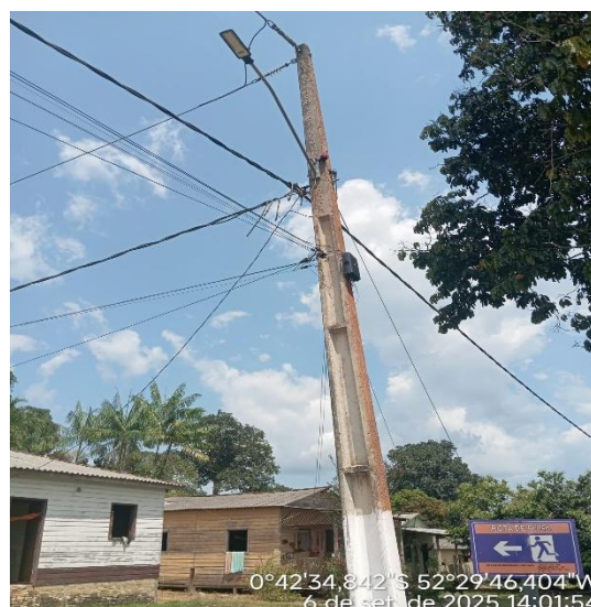
Figura 10: Poste de Iluminação Pública na comunidade Padaria
