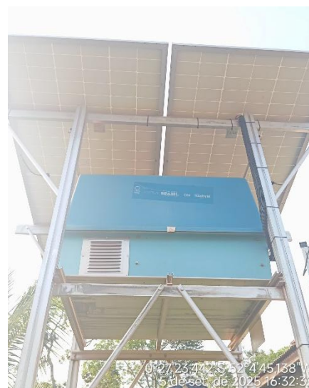
Figura 3: Painel solar e geradores distribuídos na comunidade São Pedro
