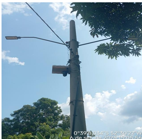
Figura 9: Poste de Iluminação na comunidade de Santo Antônio da Cachoeira
