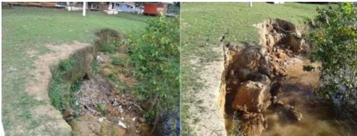
Figura 2 – Focos e erosão na orla de Ferreira Gomes - Amapá
