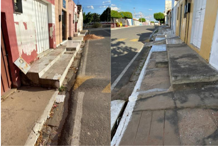
Figura 5: Calçadas irregulares na rua Francisco Macêdo e na avenida Santo Antônio.
