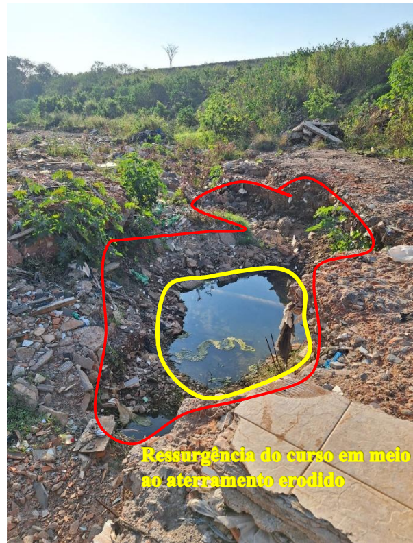
Figura 3 - Soterramento do Córrego do Socego em vermelho aterro erodido; amarelo ressurgência da água subsuperficial. Registro em campo, agosto de 2024.
