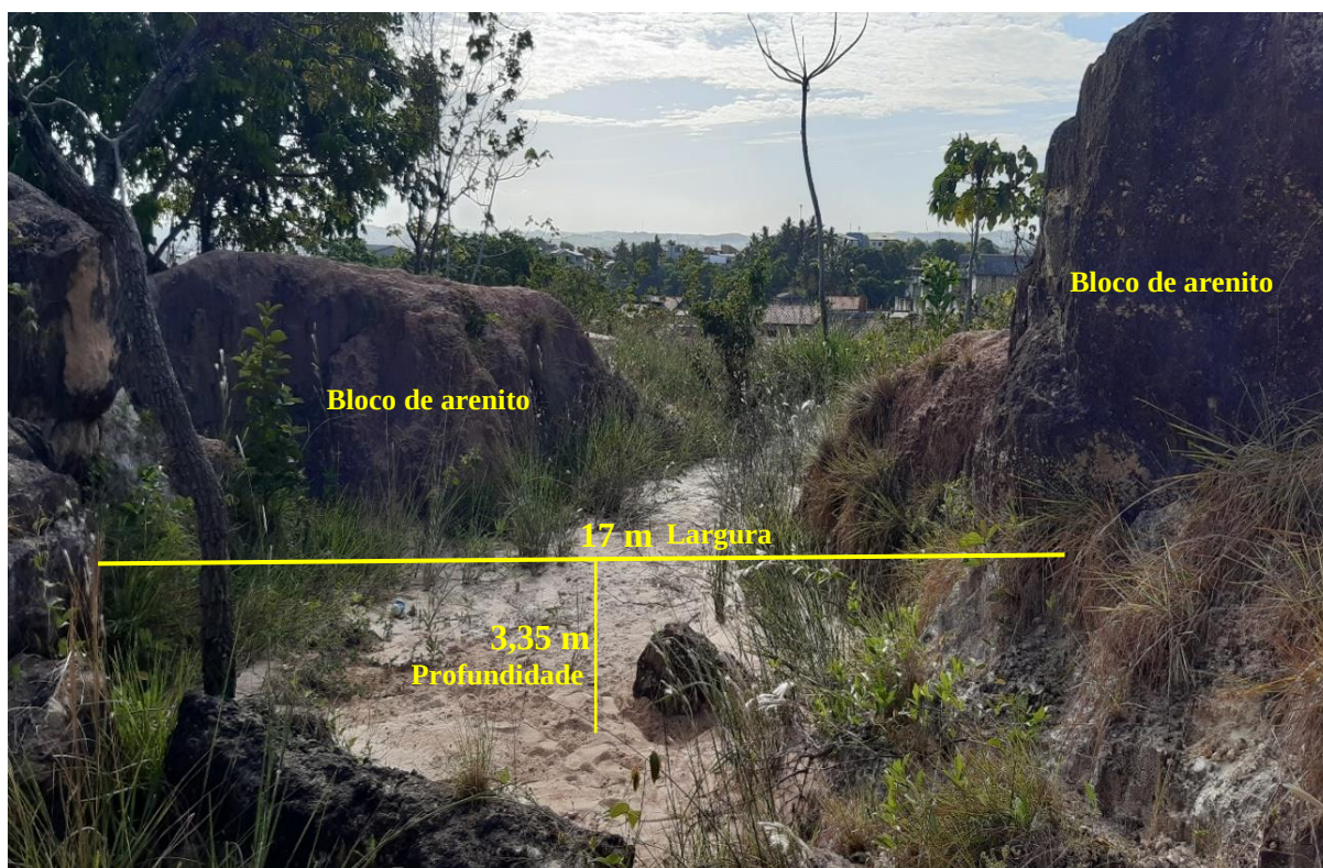
Figura 07 – Segmentos de uma mesma voçoroca evidenciando estágio avançado do processo erosivo. Proximidades da rua D, Bairro Cidade Nova. Ao fundo além da construção de casas de ocupação voluntária, tem-se condomínios populares de apartamentos construídos na parceria do Governo Federal (Caixa Econômica) com a iniciativa privada através de construtora.
