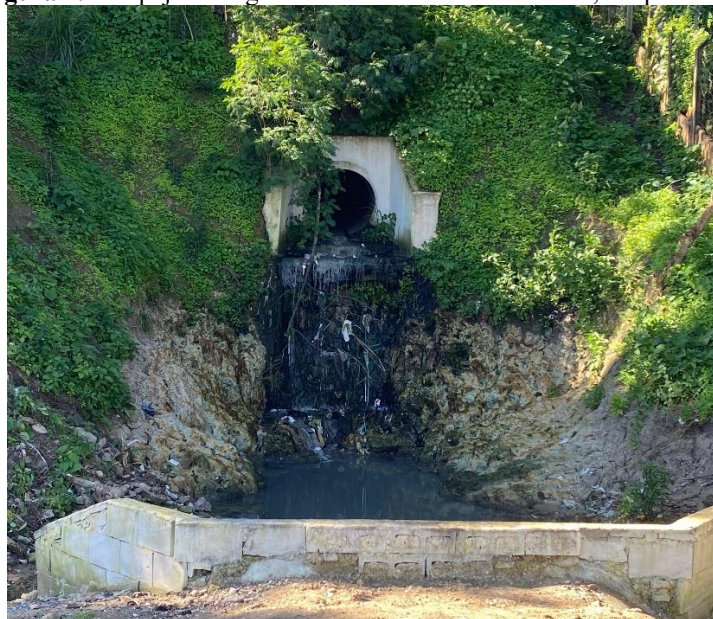
Figura 4. Despejo de esgoto em trechos do Riacho Piauí, Arapiraca - AL
