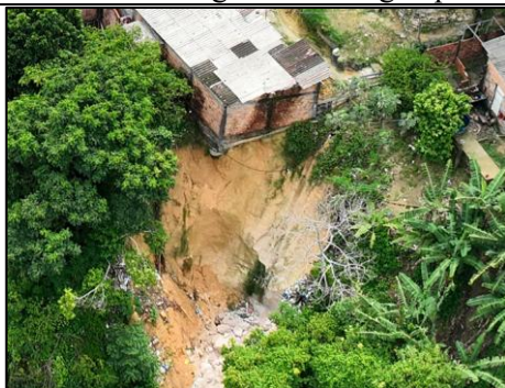
Risco de Erosão e Deslizamento
