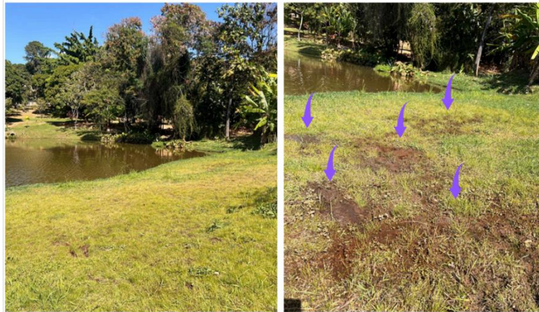
Figura 3: AU localizada no Parque Nossa Senhora do Carmo. Detalhe para o acúmulo de água
